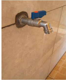
Gambar 4.5 Kran air yang bocor
